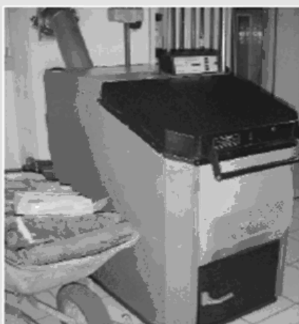
6.1 Котел на основе биомассы
